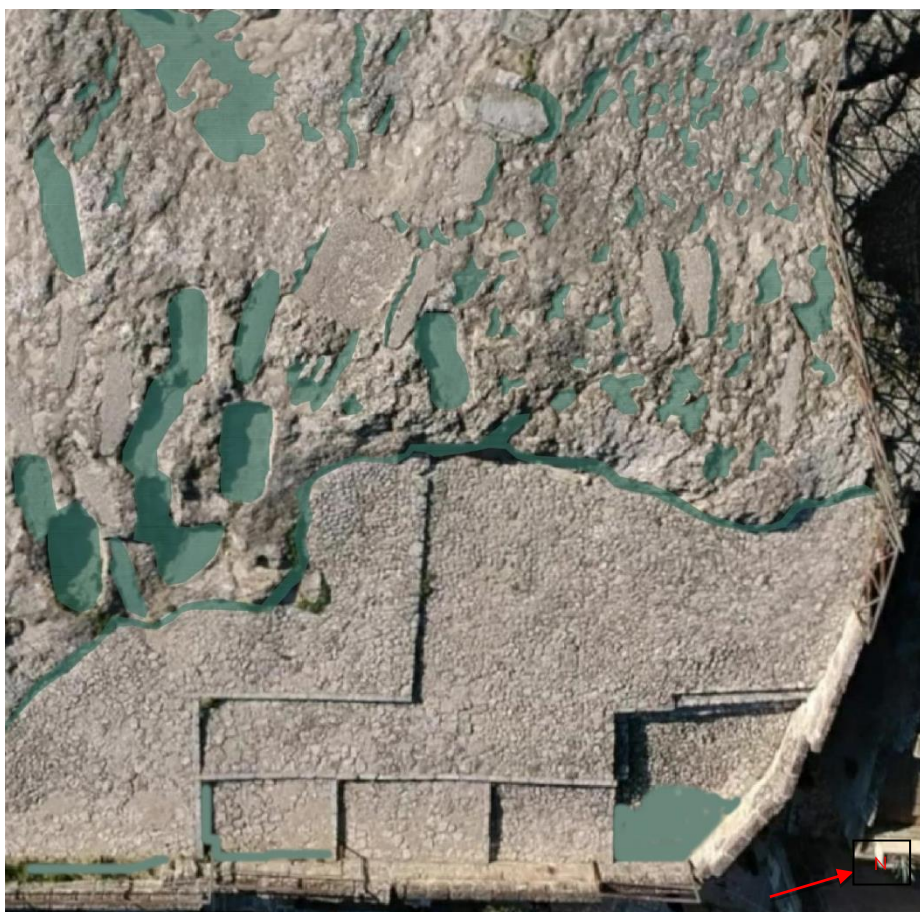
Fenomeni di accumulo delle acque nelle depressioni dell'estradosso della chiesa (evidenziati graficamente in verde)
